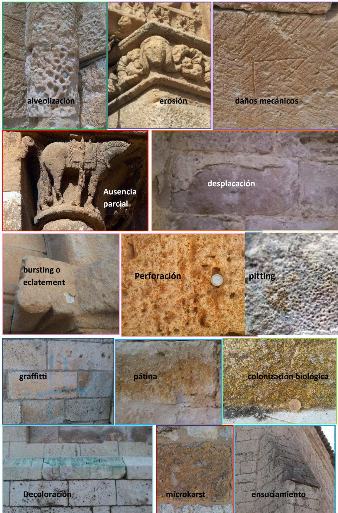
Fig.5.6. Ejemplos de patologías
