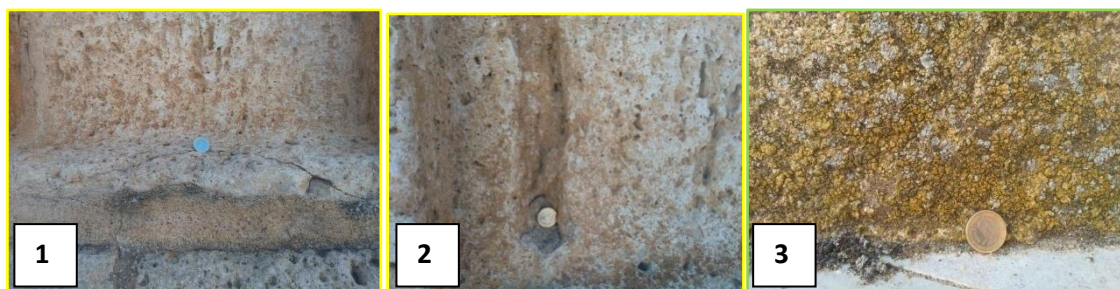
Fig.4.31..Muestra de las patologías.
