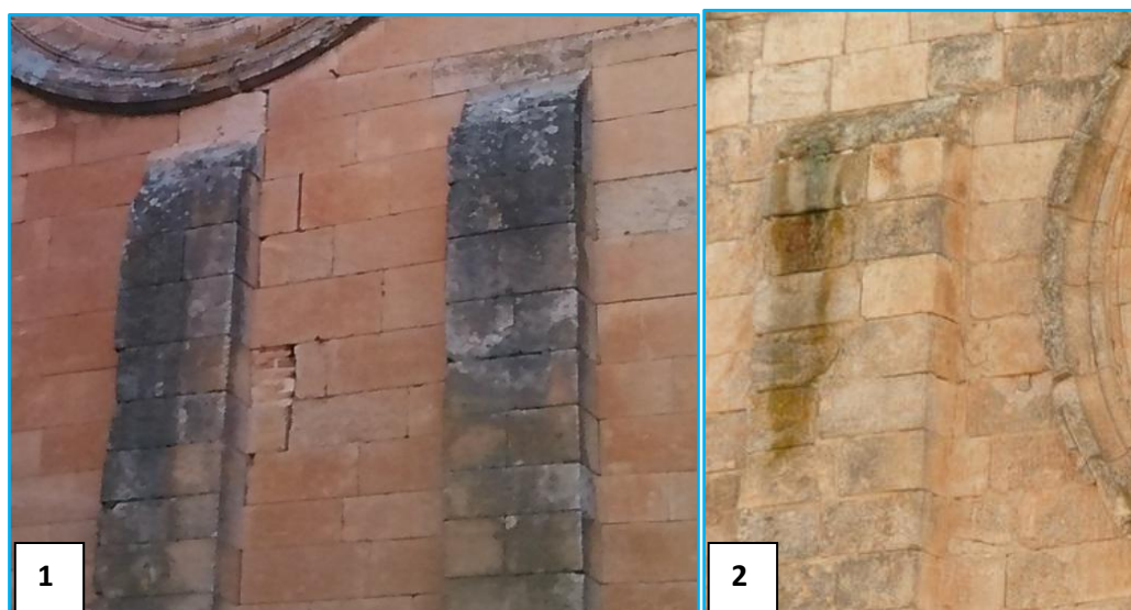
Fig.4.55.. Muestra de las patologías.
