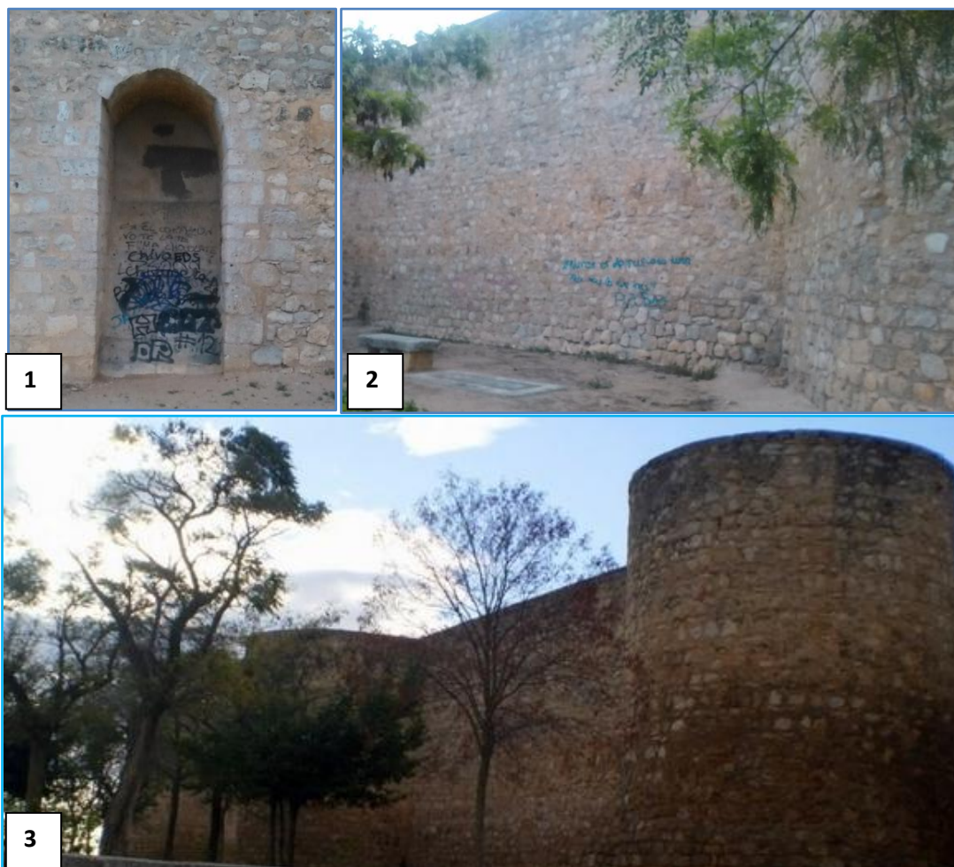
Fig. 4.17. Muestra de las patologías.
