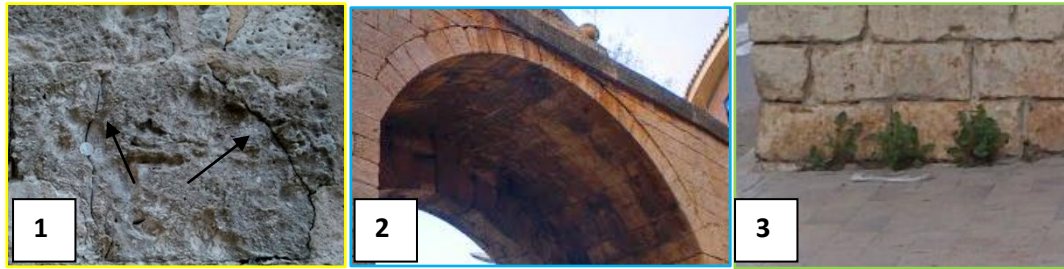
Fig.4.132. Muestra de las patologías.
