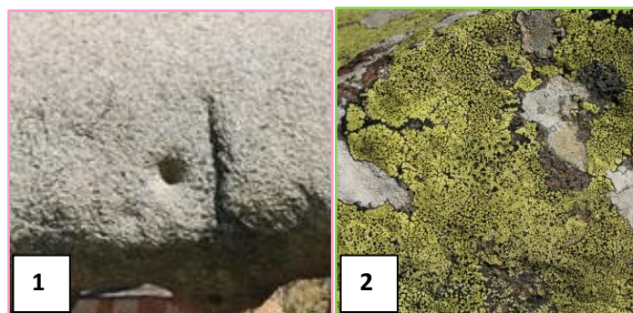
Fig. 4.7. Detalle de las patologías 1) Fisura y perforación 2) Líquenes en la caliza
