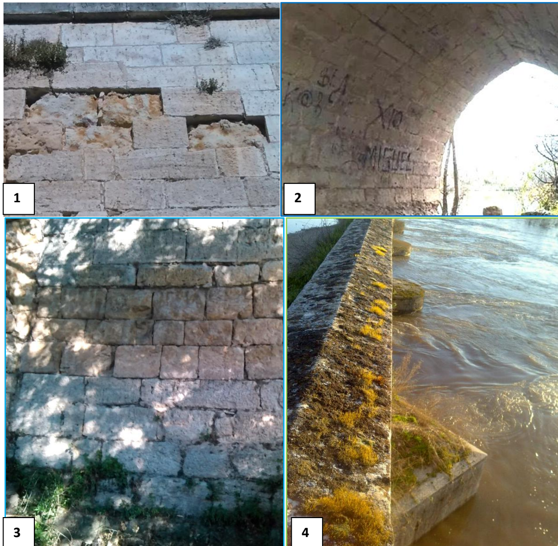
Fig.4.43. Muestra de las patologías.
