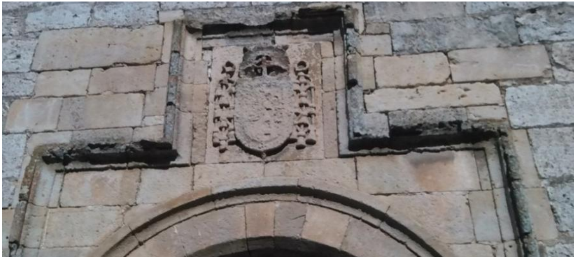
Fig.4.103. Muestra de las patologías.
