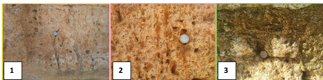
Fig.4.27 .Muestra de las patologías.
