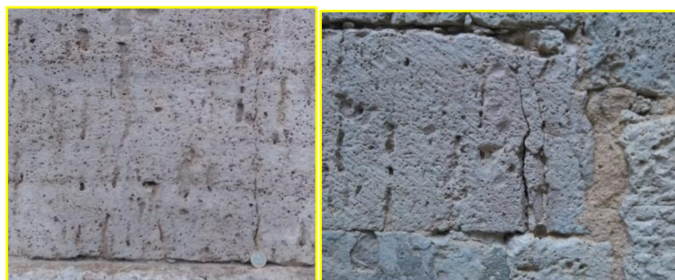
Fig.4.178. Muestra de las patologías.
