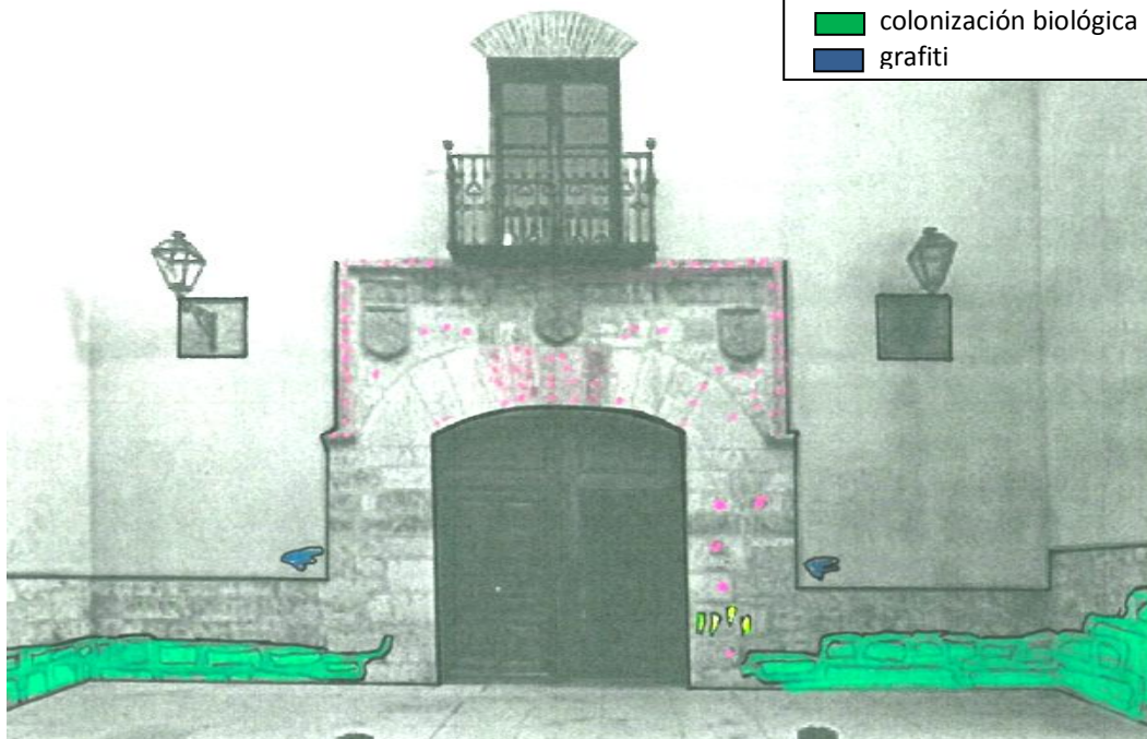
Fig. 4.116. Fachada palacio de los marqueses de Castrillo. Patologías presentes en ella.
