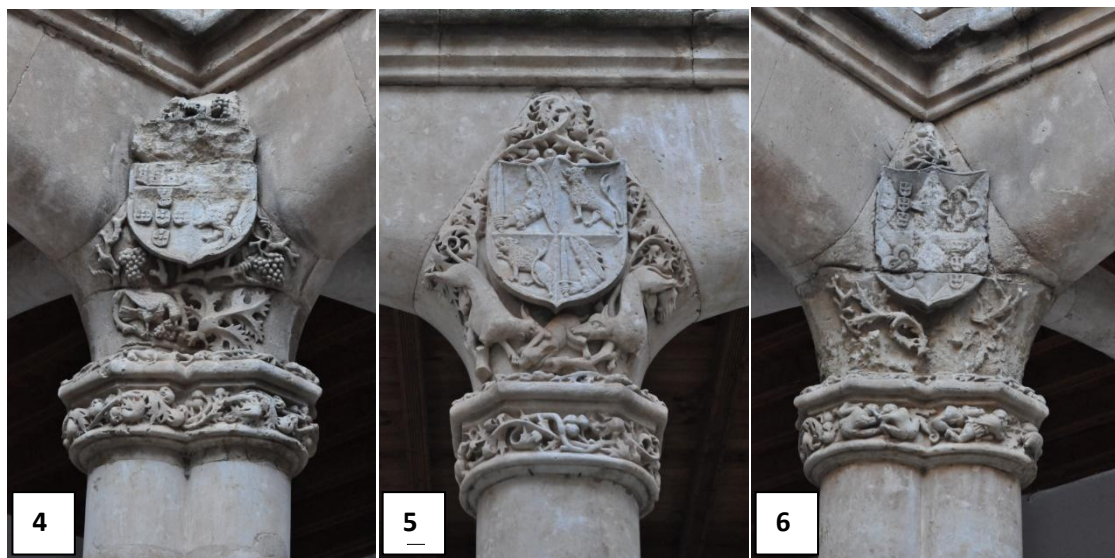
Fig.4.85. Muestra de las patologías
