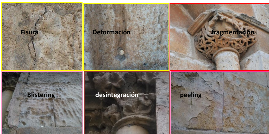
Fig.5.5. Ejemplos de patologías
