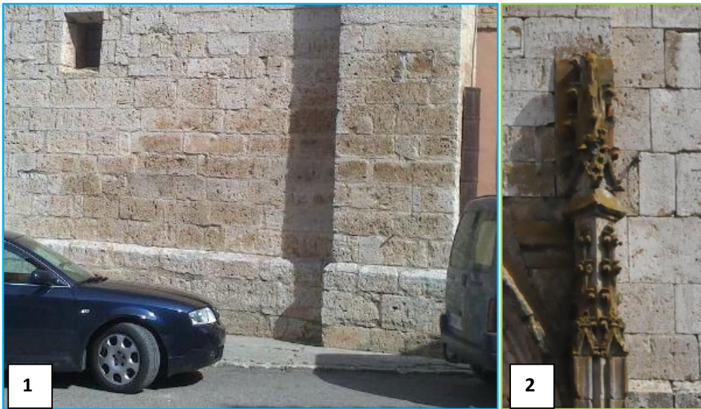
Fig.4.113. Muestra de las patologías.
