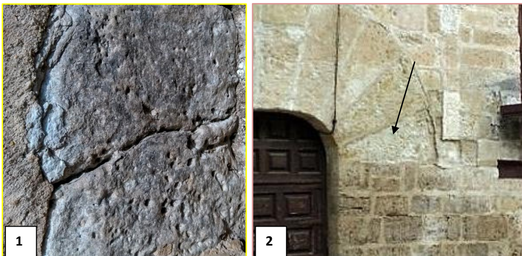
Fig.4.182. Muestra de las patologías.
