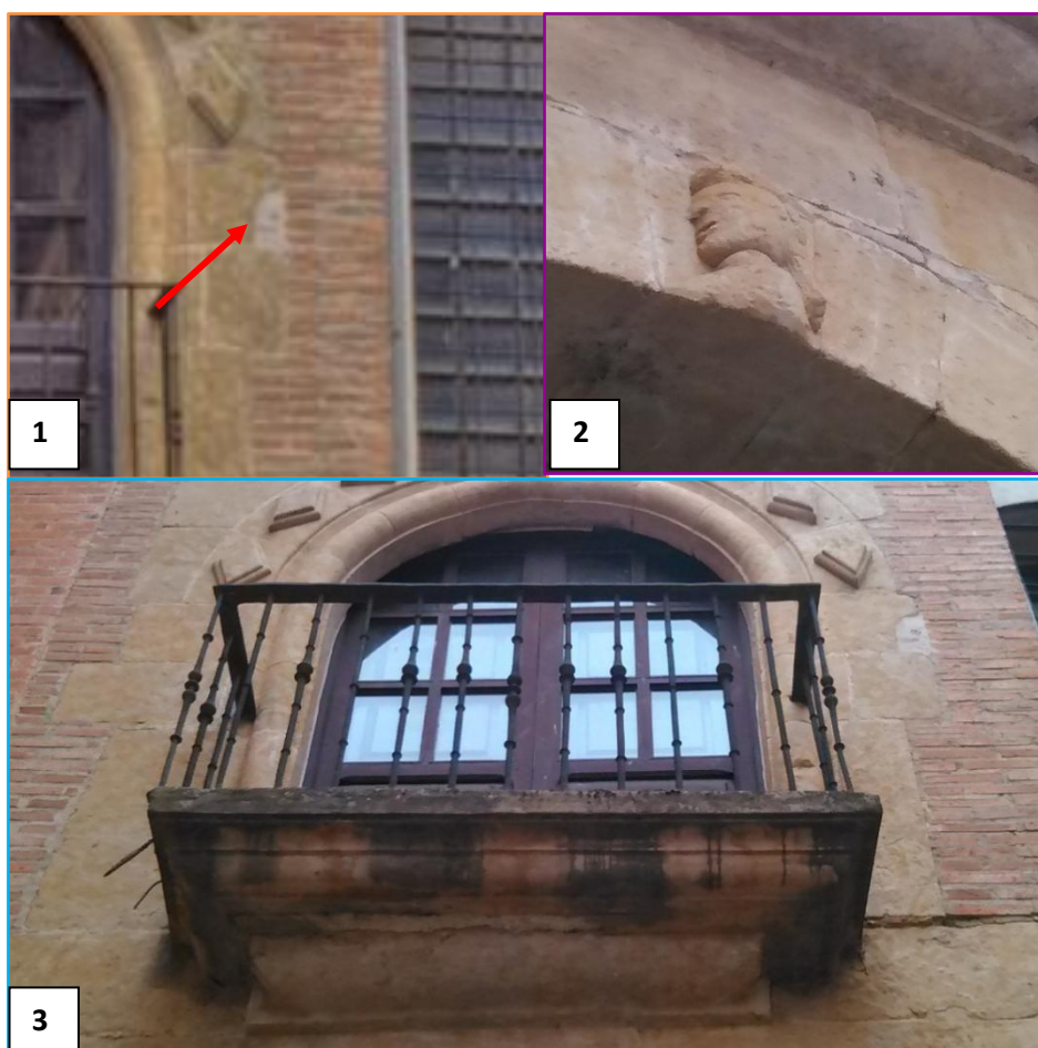
Fig.4.163 Muestra de las patologías.
