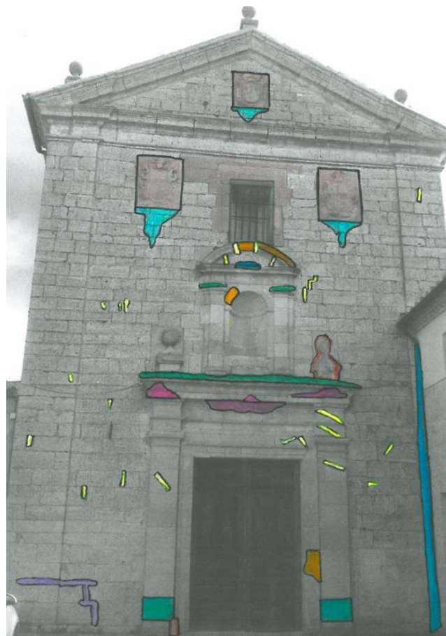
Fig. 4.120. Alzado del monasterio de San José. Patologías presentes en el monumento
