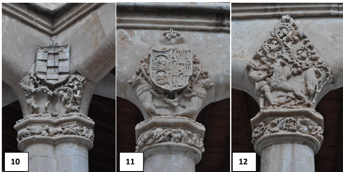
Fig.4.89. Muestra de las patologías
