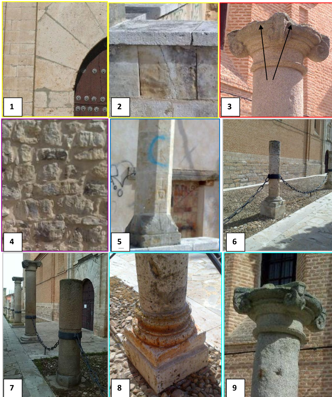
Fig.4.125. Muestra de las patologías.
