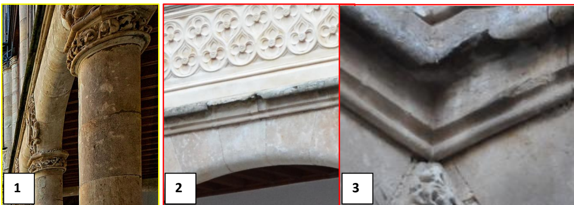
Fig.4.81. Muestra de las patologías
