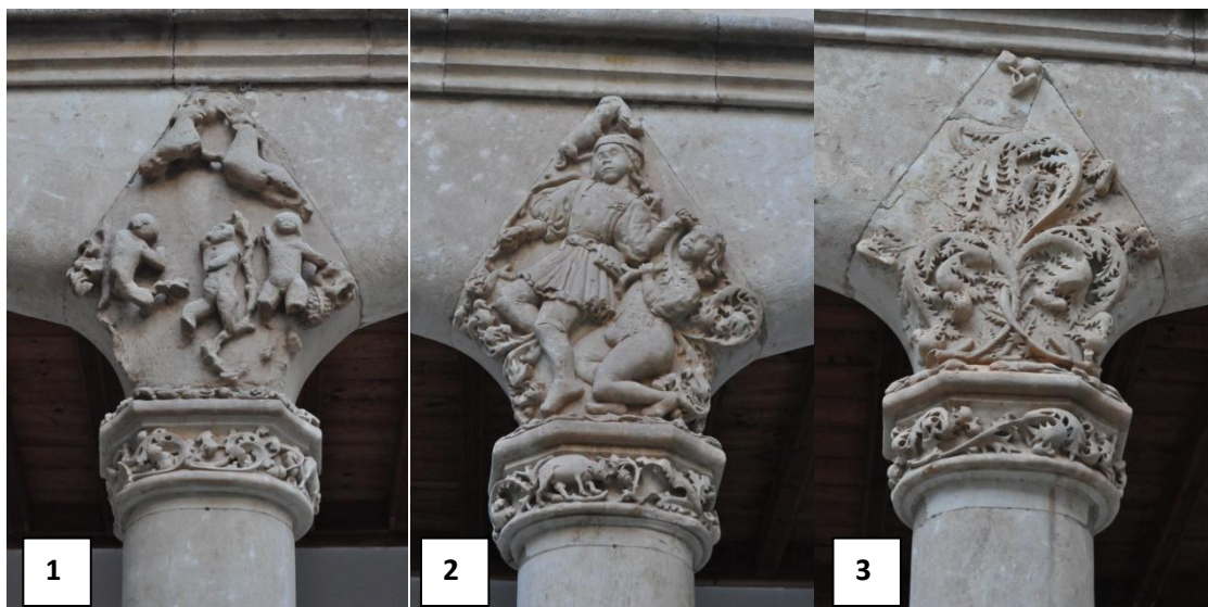
Fig.4.83. Muestra de las patologías
