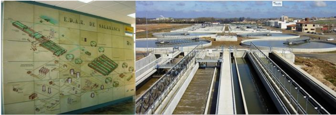
Figura 3.3. EDAR Salamanca, España. Panel eléctrico (izquierda) y equipos instalados (derecha).
