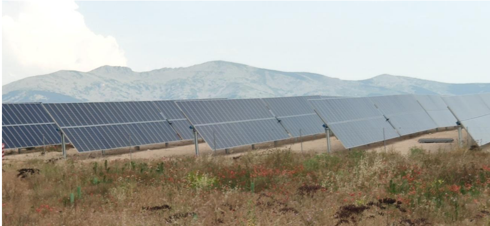
Figura 29. Fotografía de placas de la planta fotovoltaica CSF Perogordo a 20 de junio de 2020, (Fuente: elaboración propia)
