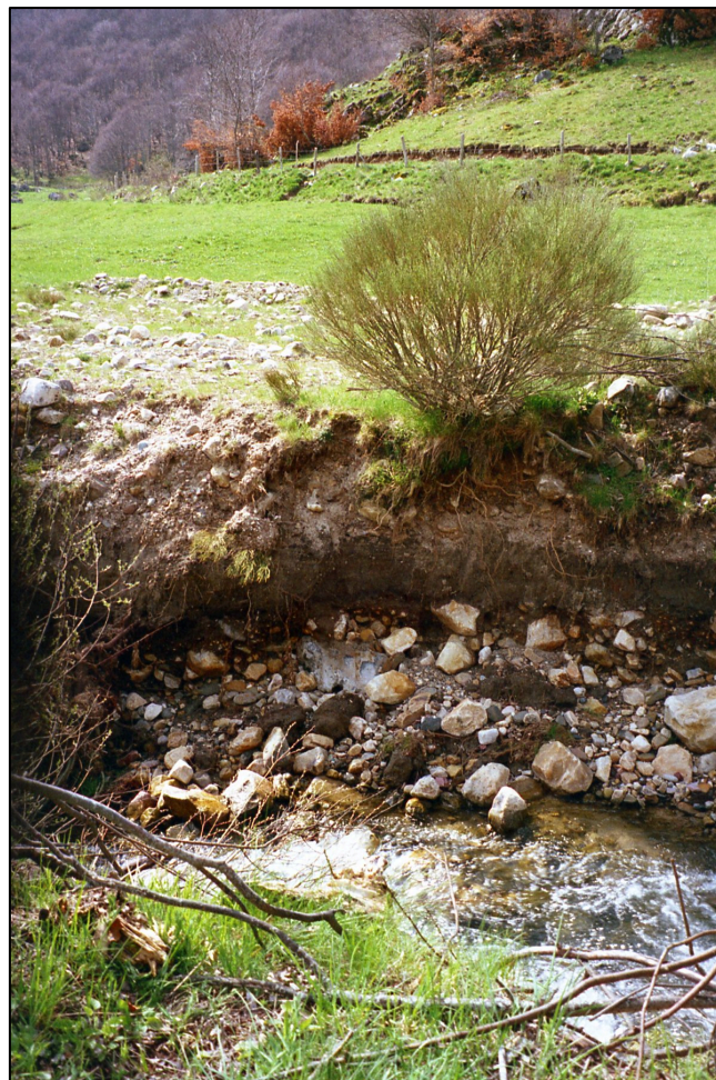
Figura 41.- Incisión vertical en el margen derecho del cauce con evidencia de desbordamiento y sedimentación de los acarreos transportados durante la avenida.
