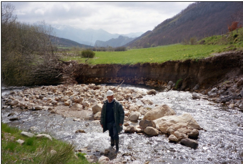
Figura 38.- Evidencia de un gran deslizamiento ocurrido debido a la mayor curvatura del cauce en este punto.
