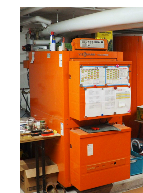
Detalle ubicación de la caldera
