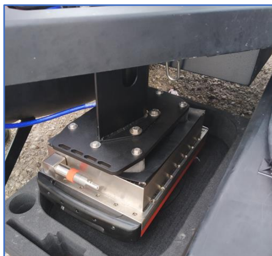
Figura 15. Detalle instalación del sondador.
