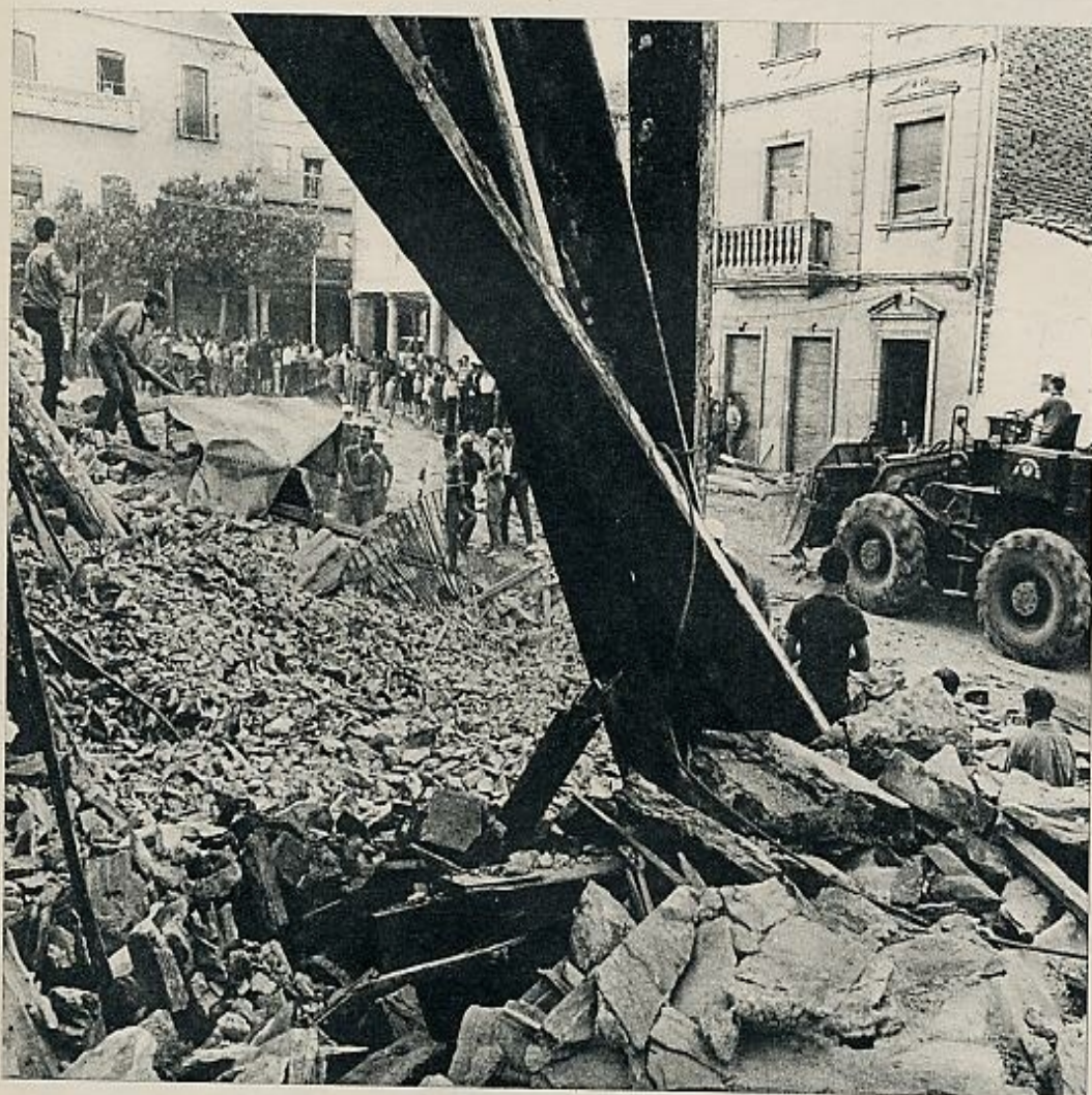
A los cinco minutos de caer el último novillo de la tarde, explotó el almacén de jamones y voló el edificio de tres plantas.
