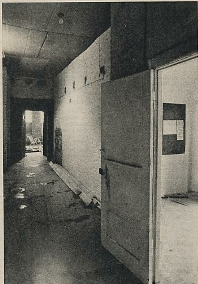
Para el centro español de Berlín se aprovechó el local de una pequeña fábrica abandonada en el seno de un patio interior de barrio obrero berlinés. En la foto, interior del centro en la primera fase de trabajo.
