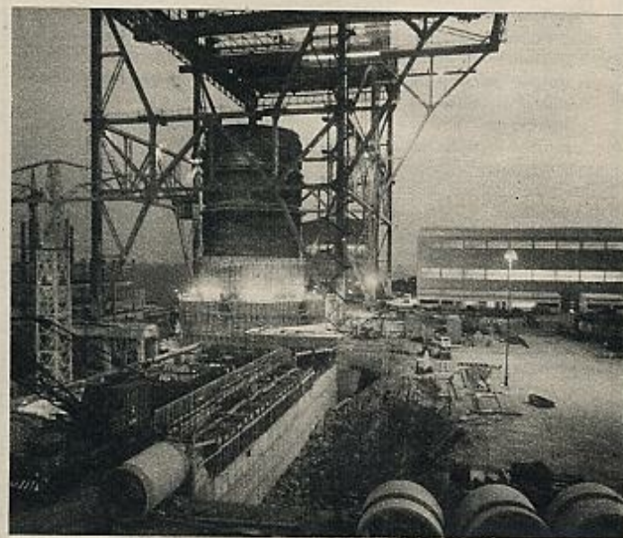
Central nuclear de Vandellós.
