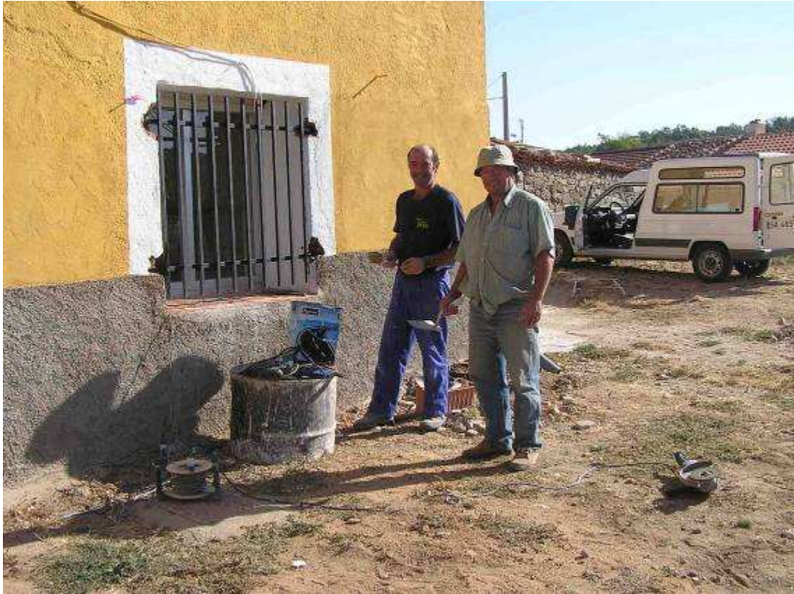
Imagen 10. Poniendo las rejas en la casa. Manuel con la ayuda del albañil está colocando las rejas protectoras en la ventana de su casa.
