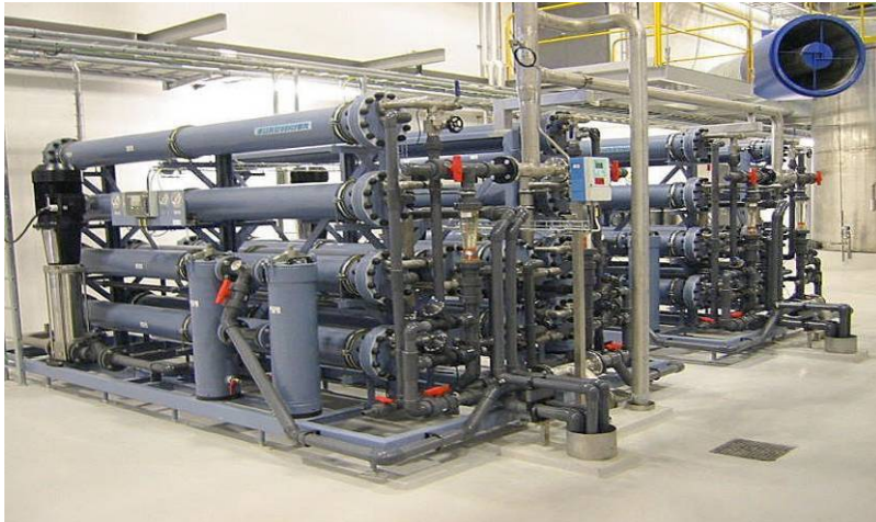
Figura 2.7.- Planta de ósmosis inversa
