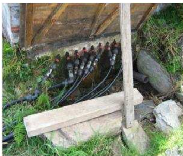
Figura 6.210 – Foto (2008) – Sistema elétrico para abastecimento de água.
