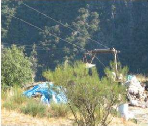
Figura 6.213 – Foto (2008) – Elevador de cabos para decida de alimentos e equipamentos para a Ecoaldeia
