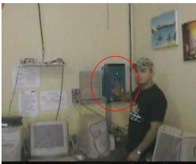
Figura 27: O conversor de energia solar em elétrica.
